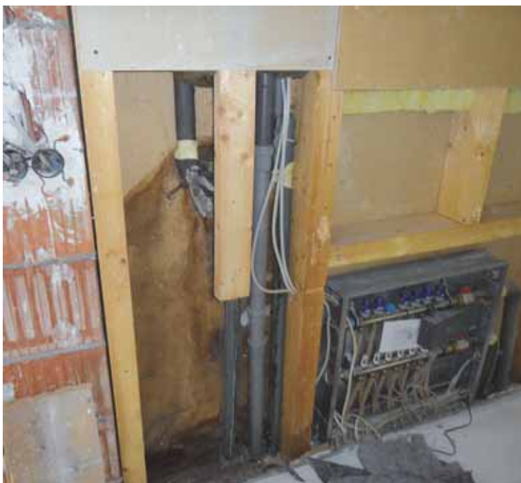
Die Spannung in Elektrokabeln erzeugt elektrische Wechselfelder. Bei Leichtbauwänden mit Metallständer-Elementen werden diese Felder sogar über die gesamten Flächen der Wände weiterverbreitet. Foto: Grossmann
